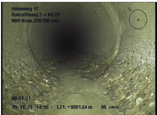
Foto: 6_5A 1.6m, Rohrknick nach links / Muffe leicht ausgebrochen
