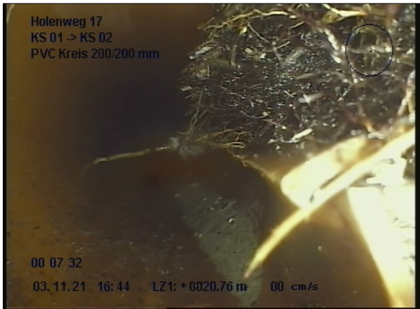
Foto: 5_6B 20.6m, Muffe, starker Wurzeleinwuchs, von 02 bis 07 Uhr / Rohr gerissen
