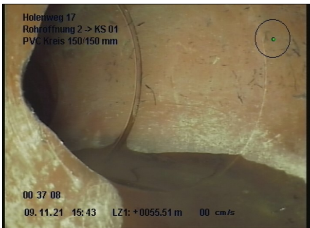
Foto: 6_32A 55.5m, Bogen nach links / ausgebrochen Loch, Ortung: T.= ca. - 2.38m
