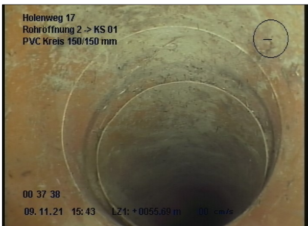
Foto: 6_33A 55.6m, Gefällsbruch stark / auf KS 01
