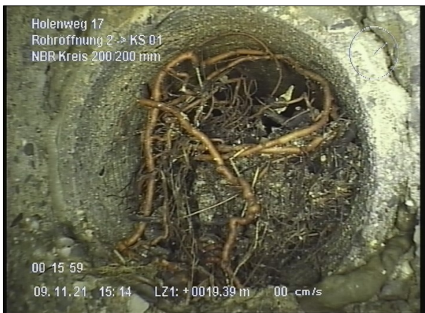
Foto: 6_14B 19.2m, Einlauf, von 01 bis 03 Uhr, Wurzeleinwuchs / nicht verputzt von Brunnen ??
