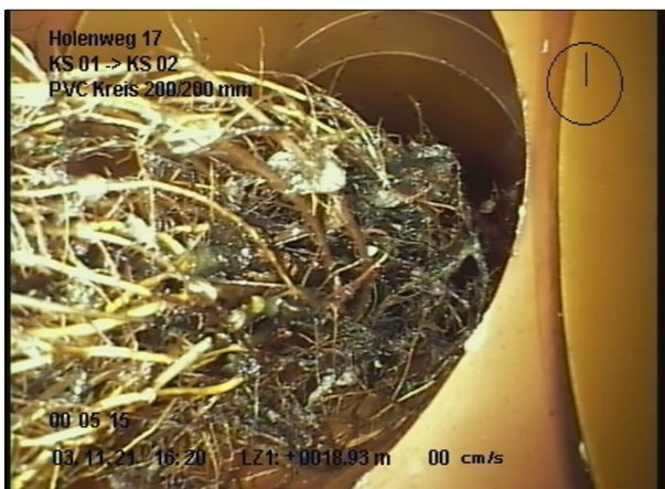
Foto: 5_5B 18.8m, Abzweiger von 10 bis 02 Uhr / von Brunnen Wurzeinwuchs
