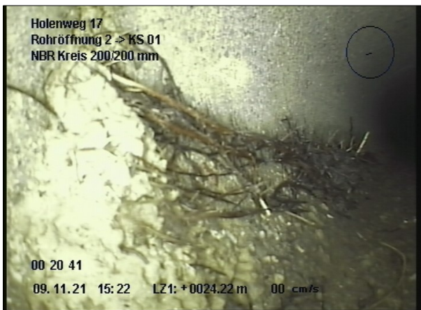
Foto: 6_17B 24m, Muffe, Wurzeleinwuchs, von 07 bis 08 Uhr
