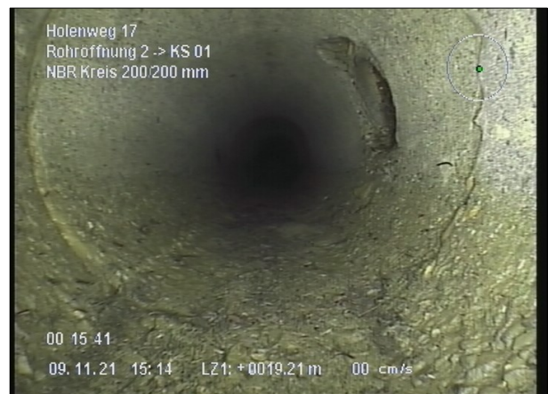
Foto: 6_14A 19.2m, Einlauf, von 01 bis 03 Uhr, Wurzeleinwuchs / nicht verputzt von Brunnen ??
