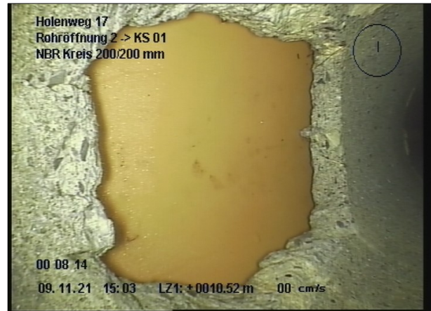
Foto: 6_10B 10.5m, Reparaturstelle von 11 bis 01 Uhr
