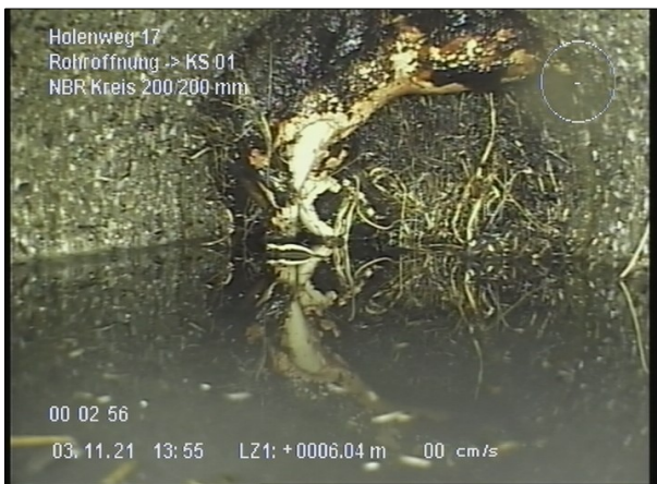
Foto: 3_4A 6m, Wurzeleinwuchs, stark, von 12 bis 12 Uhr
