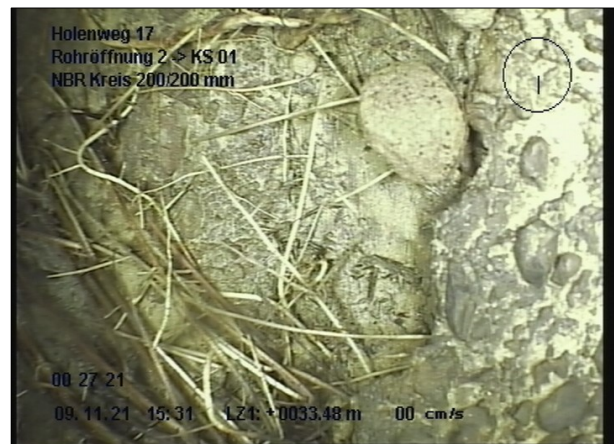
Foto: 6_24B 33.2m, Muffe, leicht Wurzeleinwuchs, von 04 bis 08 Uhr / leicht ausgebrochen
