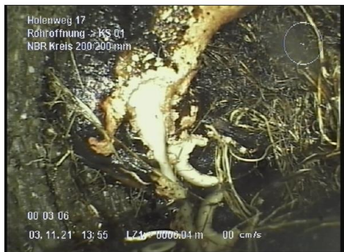
Foto: 3_4B 6m, Wurzeleinwuchs, stark, von 12 bis 12 Uhr
